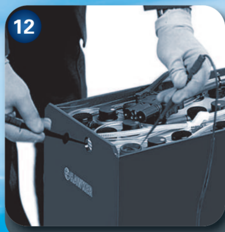
12 Mesurer la valeur d'isolement. Valeur de consigne: 50 Ohm par Volt de tension nominale.
